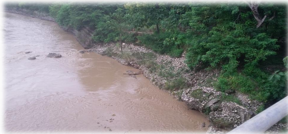
Gambar 1.1 Kerusakan Bronjong Akibat Arus Banjir
