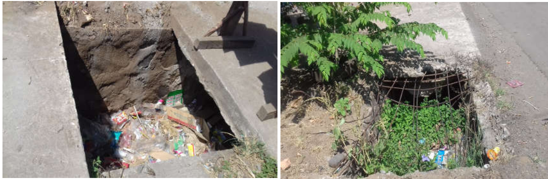
Gambar 1.1 Kondisi Drainase di Jalan Trans Lembata Sumber : Dokumentasi, 2018
