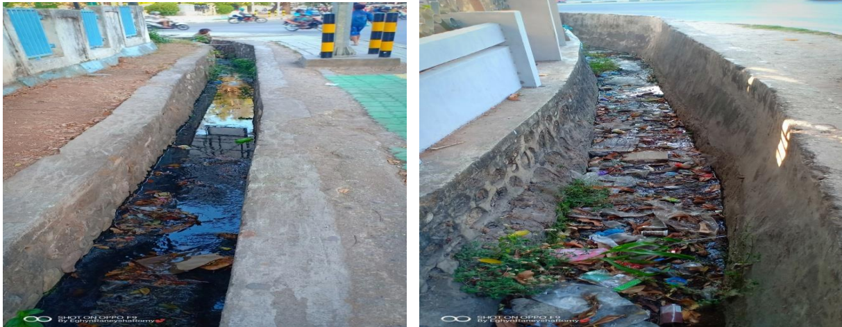
Gambar 1.2 : Kondisi Saluran Drainase di perempatan Polda NTT Kupaang. Sumber : Dokumentasi
