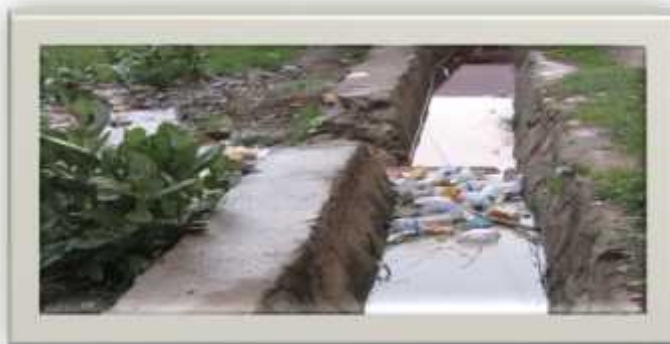
Gambar 1.2 Penumpukan Sampah di saluran drainase Lokasi : Jln. Kusambi 3
