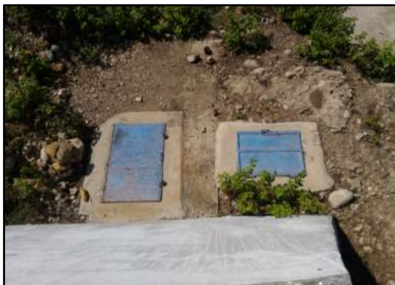
Gambar 4.22 : Kondisi Pipa Transmisi
