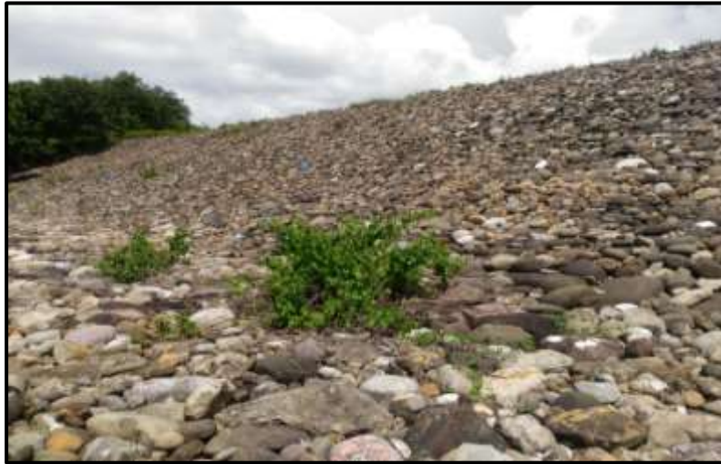
Gambar 4.4 : Kondisi Retakan Melintang di Tubuh Embung
