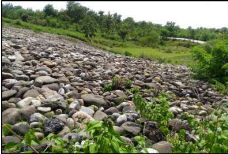
Gambar 4.2 : Kondisi Tubuh atau Fondasi Embung Daerah Basah karena Longsor Lokal
