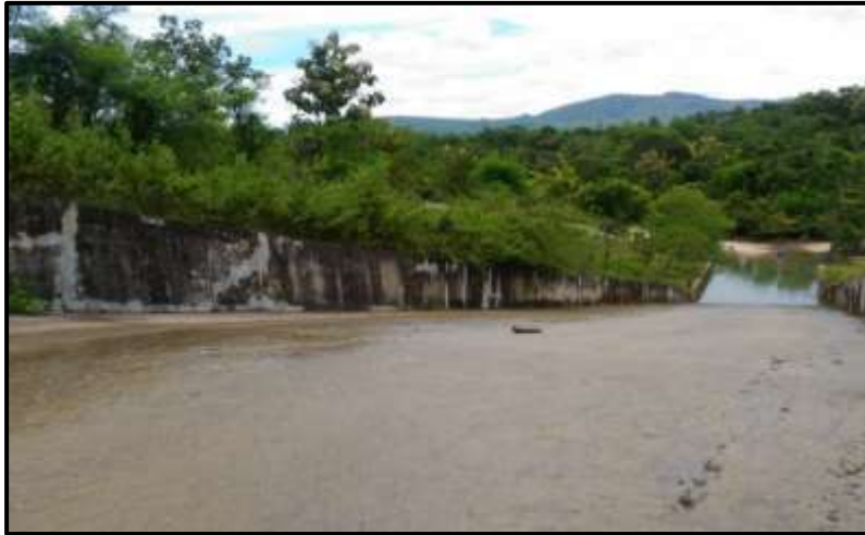
Gambar 4.13 : Kondisi Tumbuhan Tinggi pada Pelimpah Sumber : Dokumentasi (2018)
