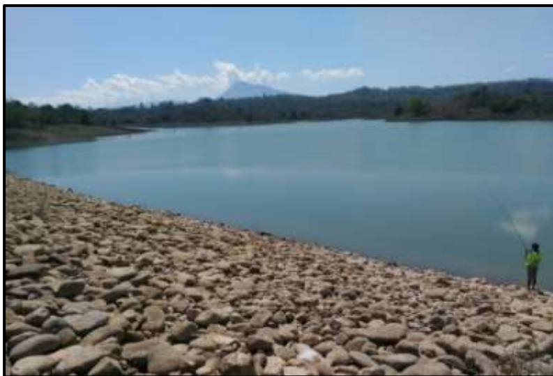
Gambar 4.7 : Kondisi Erosi Alur di Tubuh Embung
