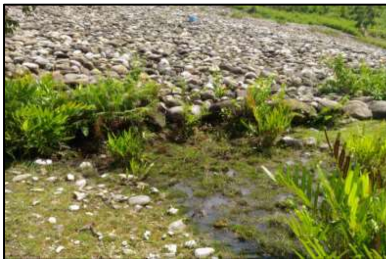
Gambar 4.3 : Kondisi Daerah Basah Memanjang Tubuh Embung karena Rembesan
