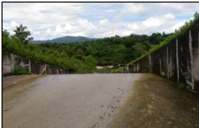
Gambar 4.10 : Kondisi Runtuhan Saluran Pelimpah
