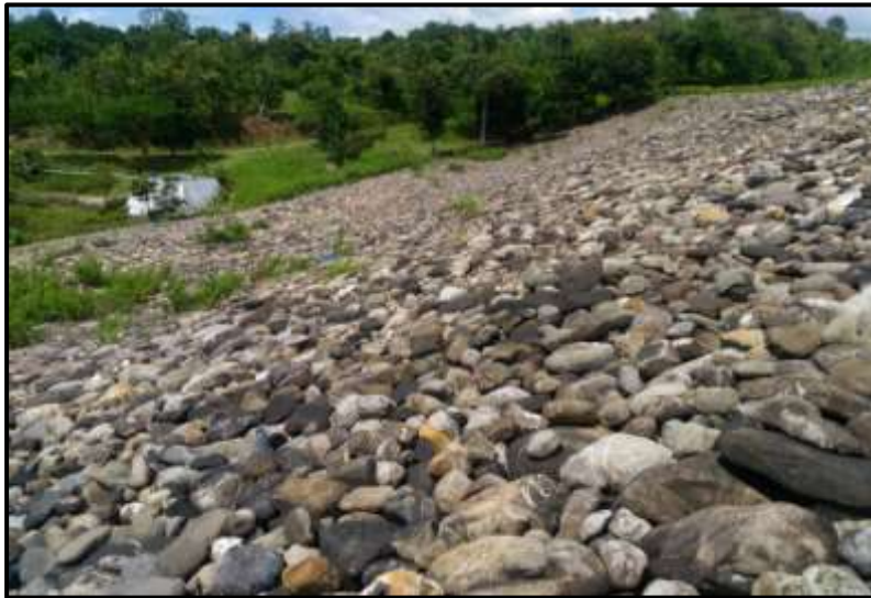
Gambar 4.6 : Kondisi Retakan Susut
