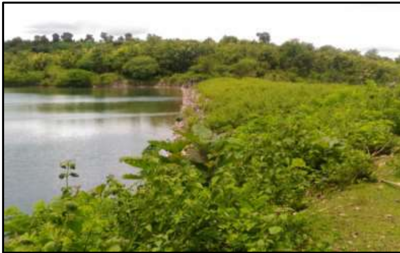
Gambar 4.8 : Kondisi Tumbuhan Tinggi di Tubuh Embung Sumber : Dokumentasi (2018)
