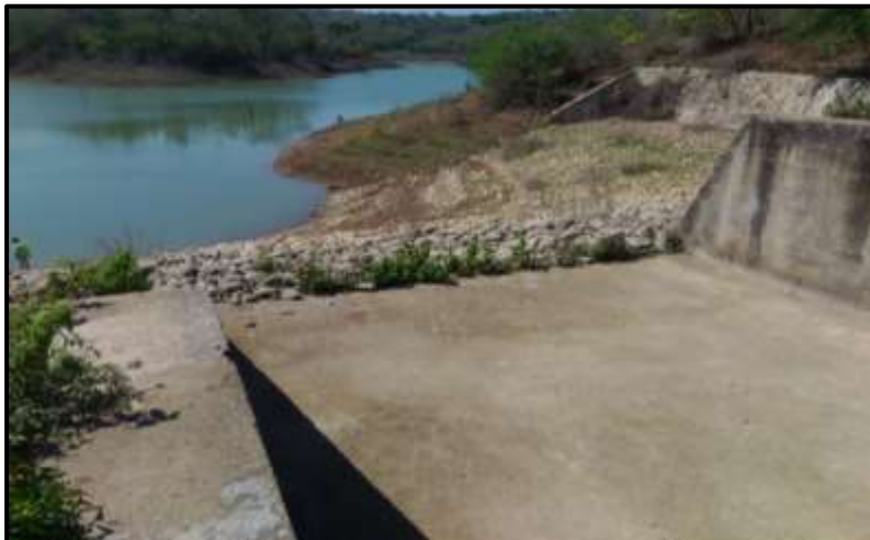
Gambar 4.12 : Kondisi Gerusan Lokal Saluran Pelimpah
