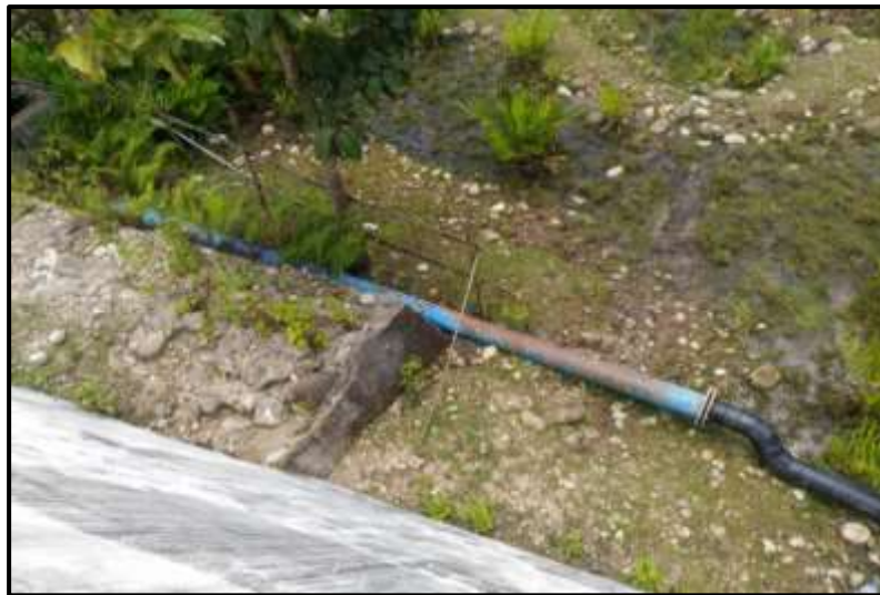
Gambar 4.23 : Kondisi Pipa Distribusi Sumber : Dokumentasi (2018)
