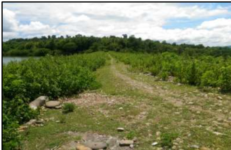
Gambar 4.5 : Kondisi Retakan Memanjang di Tubuh Embung Bagian Puncak
