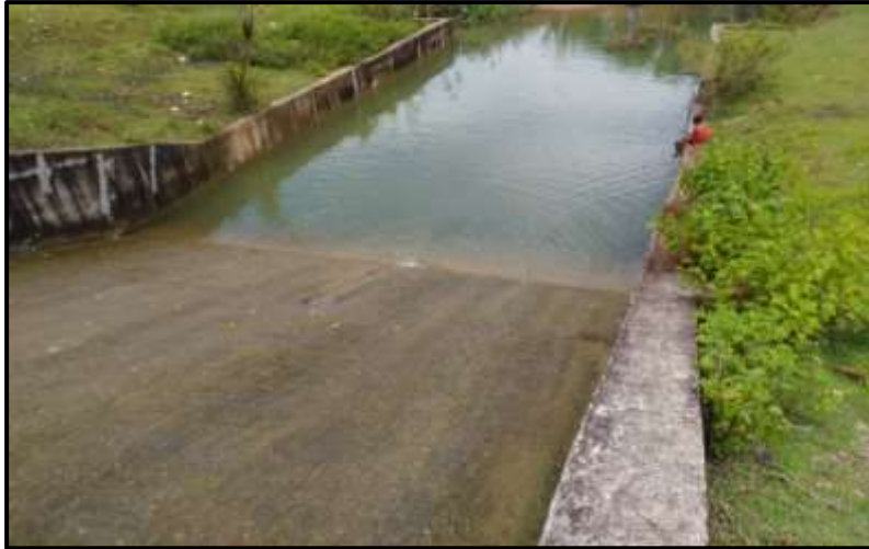
Gambar 4.11 : Kondisi Erosi Alur Saluran Pelimpah
