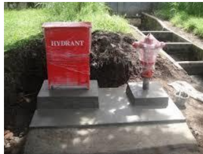
Gambar 4.89 Hydrant box dan hydrant pilar (Sumber : Google Images)
