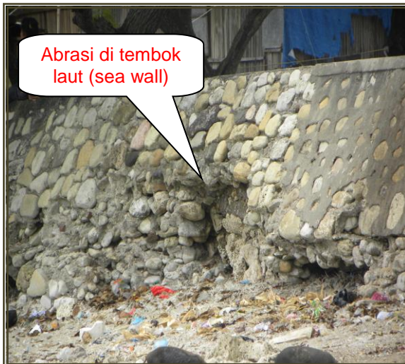
Gambar 1.2 Abrasi di Tembok Laut ( sea wall )
