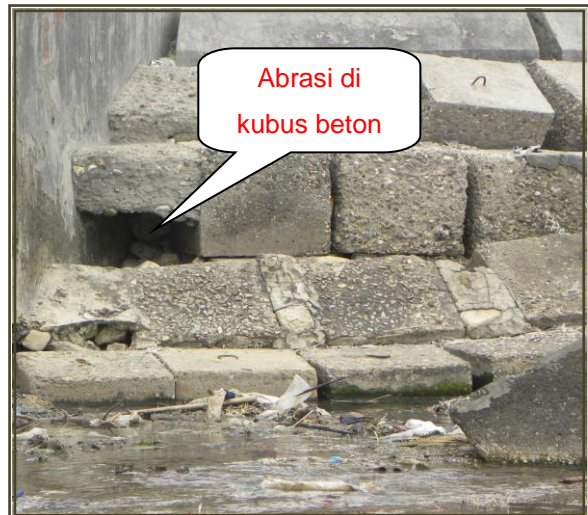
Gambar 1.3 Abrasi di Kubus Beton
