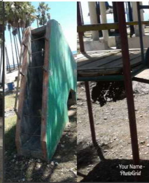
Gambar 4.4 Tempat bermain anak yang sudah rusak 12
