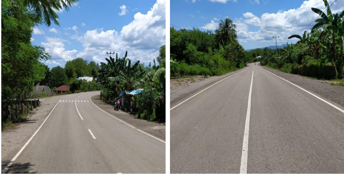
Gambar 1.1 Kondisi Eksisting Jalan Sumber : Dokumentasi Lapangan, Tahun 2022
