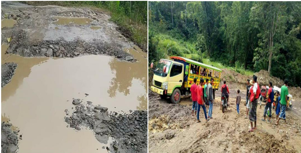
Gambar 1.1 Kondisi Jalan Kabupaten yang mengalami kerusakan di Kabupaten Manggarai Timur
