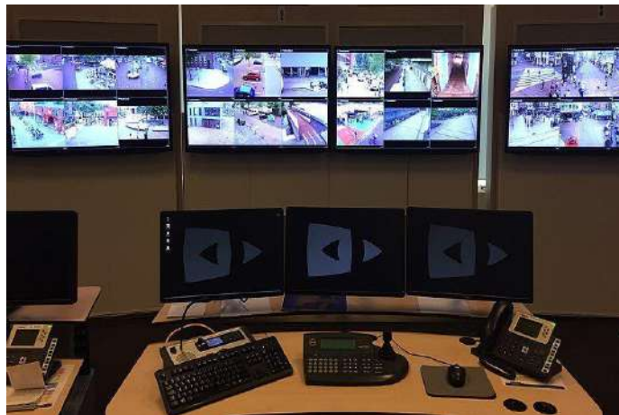
gambar 5.28 ruang pengawsan cctv
