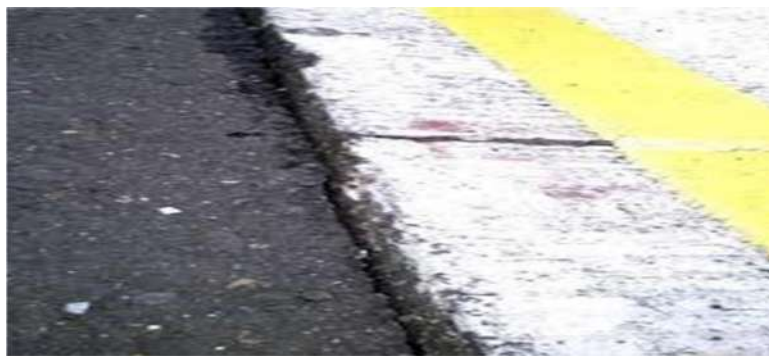
Gambar 2.7 Retak sambungan pelebaran jalan
