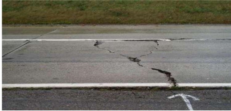
Gambar 2.5 Retak Sambungan Bahu dan Perkerasan
