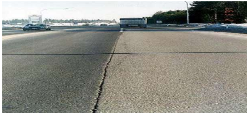
Gambar 2.6 Retak sambungan jalan
