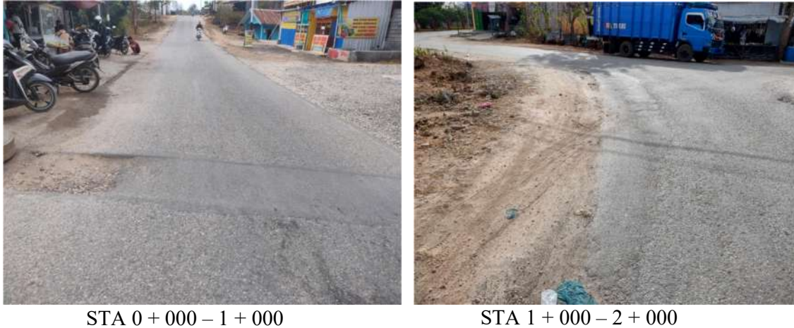
Gambar 4.11 Kerusakan Tambalan ( patching ) pada ruas Jalan Tua Bata
