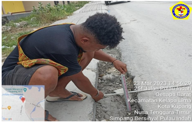
Gambar 1.2. Kerusakan pada tepi jalan
