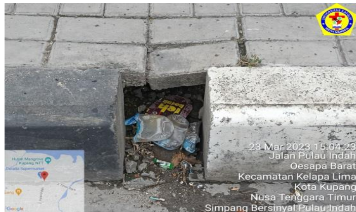
Gambar 1.6. Kondisi saluran drainase di lokasi
