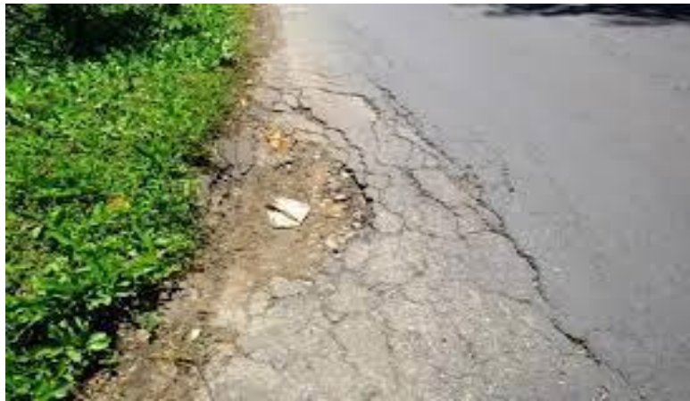
Gambar 2.3. Retak pinggir ( edge cracks )
