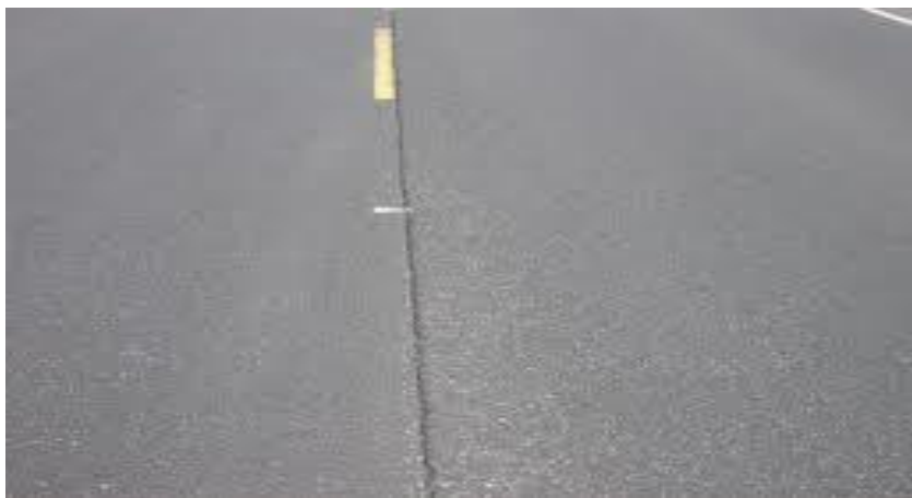
Gambar 2.4. Retak sambungan jalan ( lane joint cracks )
