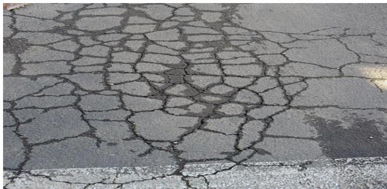
Gambar 2.2. Retak kulit buaya ( alligator crack )
