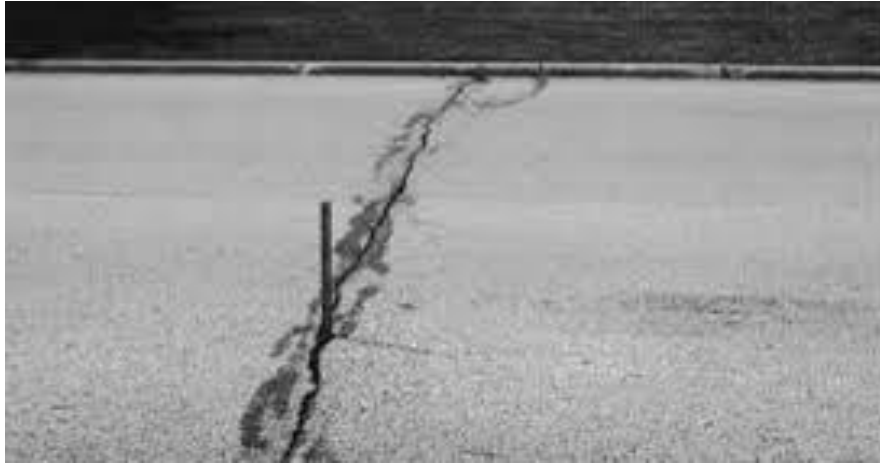
Gambar 2.5. Retak melintang atau memanjang ( transversal crack )
