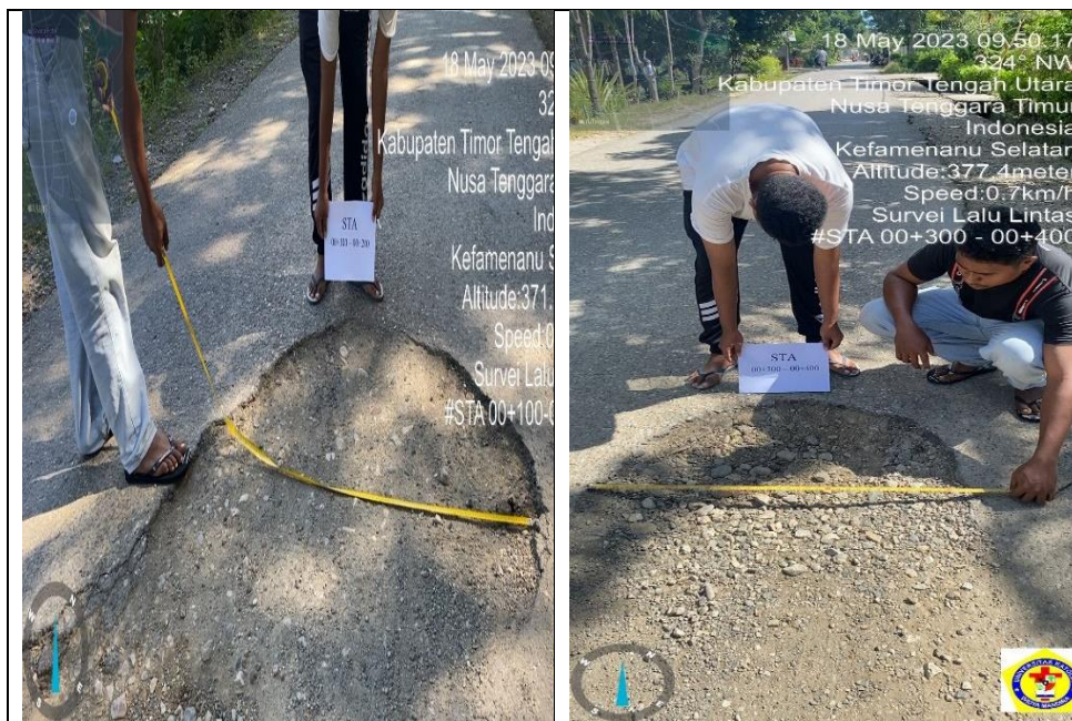
Gambar 4.1 Jenis Kerusakan Lubang Ruas Jalan Arah Terminal Kota Kefamenanu.
