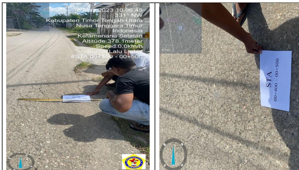
Gambar 4.3 Jenis Kerusakan Retak Kulit Buaya Di Ruas Jalan Arah Terminal Kota Kefamenanu. Sumber : Dokumentasi, 2023
