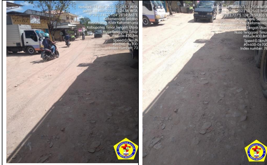
Gambar 4.4 Jenis Kerusakan Pelepasan Butiran Di Ruas Jalan Arah Terminal Kota Kefamenanu.
