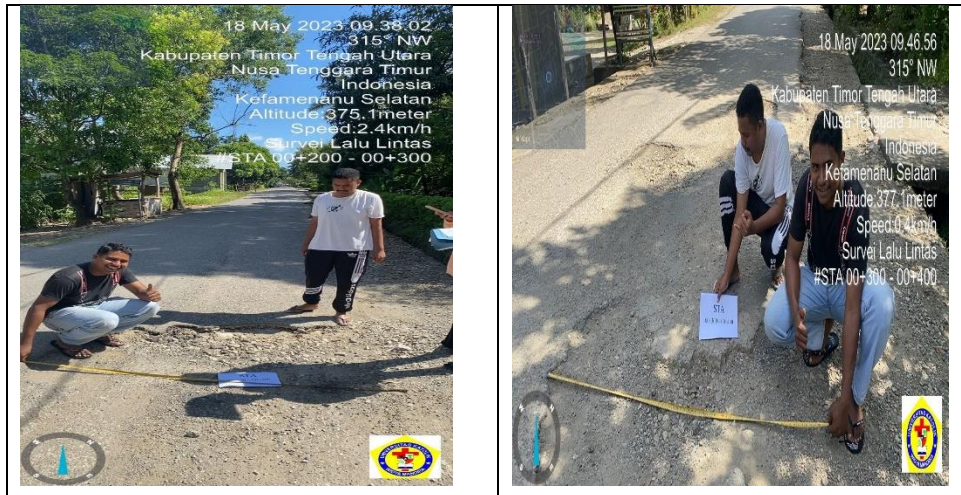
Gambar 4.2 Jenis Keusakan Retak Samping Jalan Ruas Jalan Arah Terminal Kota Kefamenanu. Sumber : Dokumentasi, 2023
