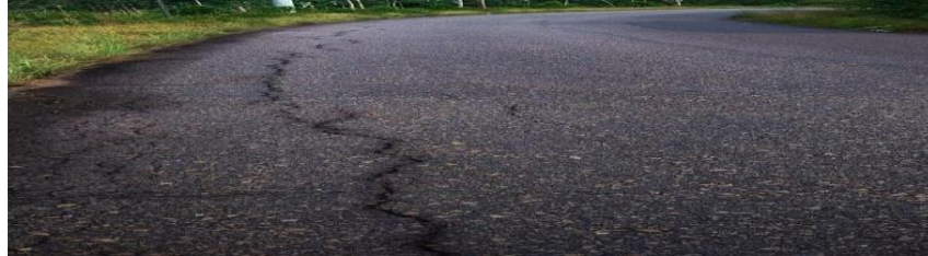
Gambar 2.7 Retak Memanjang ( Longitudial Cracks )
