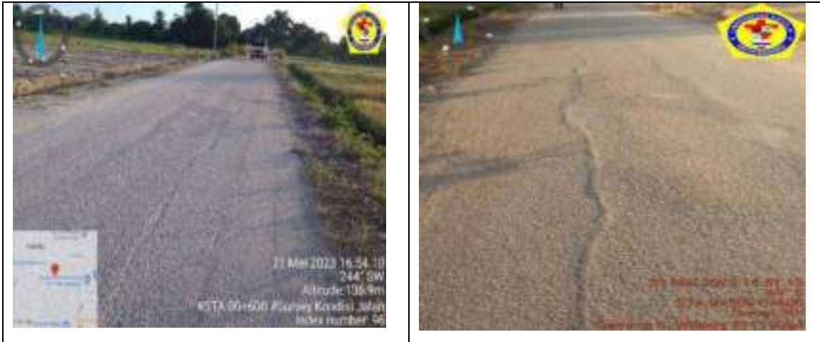
Gambar 4.15 Retak Memanjang STA 0+500 – 0+600 Sumber : Dokumentasi Lapangan (2023)
