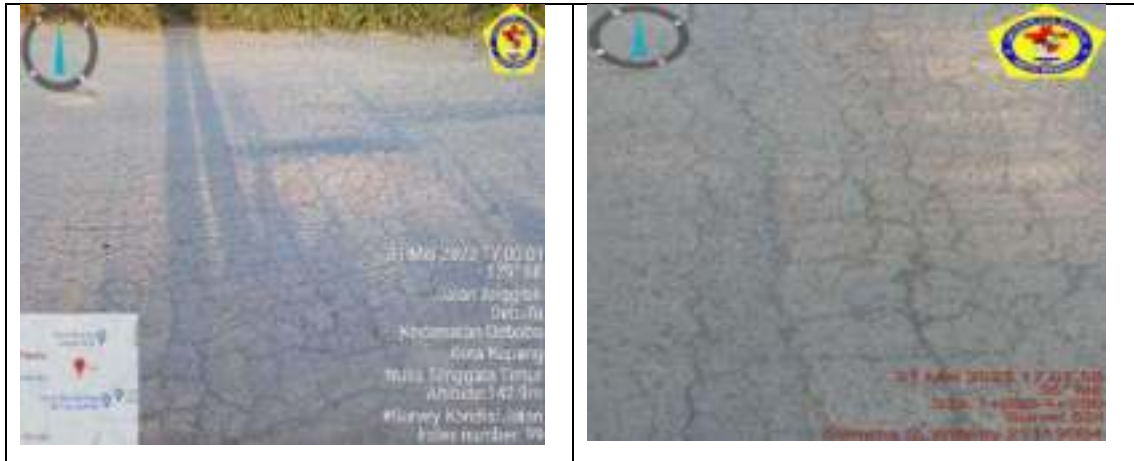
Gambar 4.13 Retak Kulit Buaya STA 1+000 – 1+145
