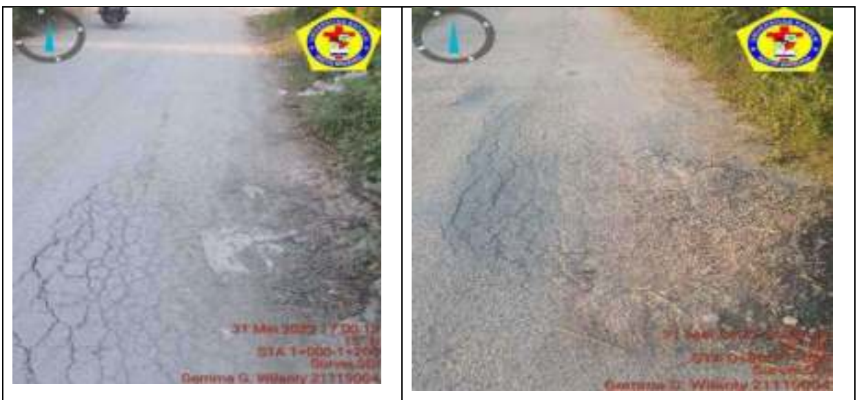
Gambar 4.16 Cacat Tepi Perkerasan STA 1+000 – 1+145 Sumber : Dokumentasi Lapangan (2023)
