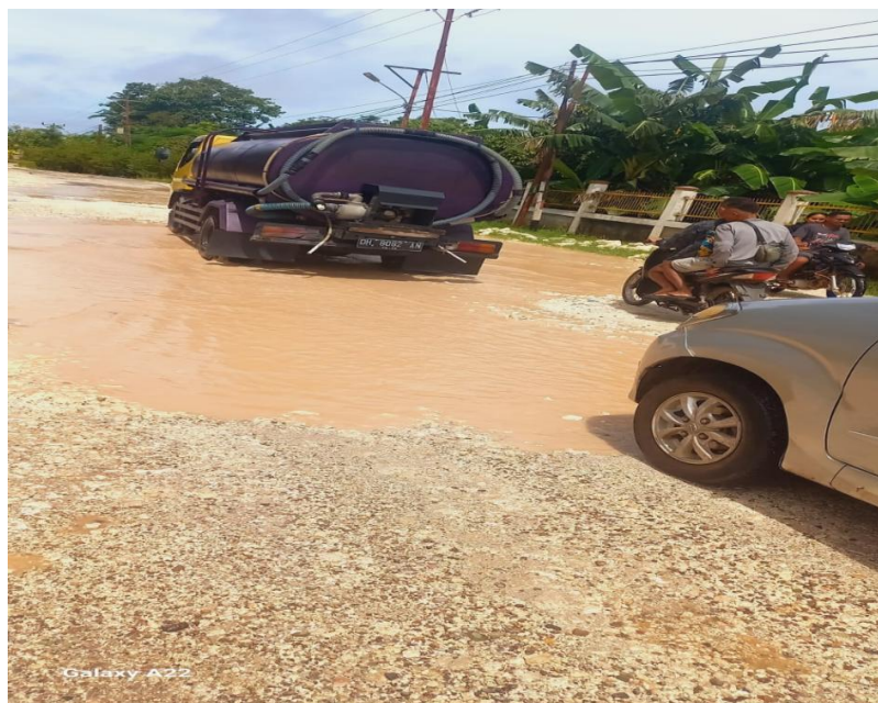
Gambar 1.2 Genangan air pada badan jalan
