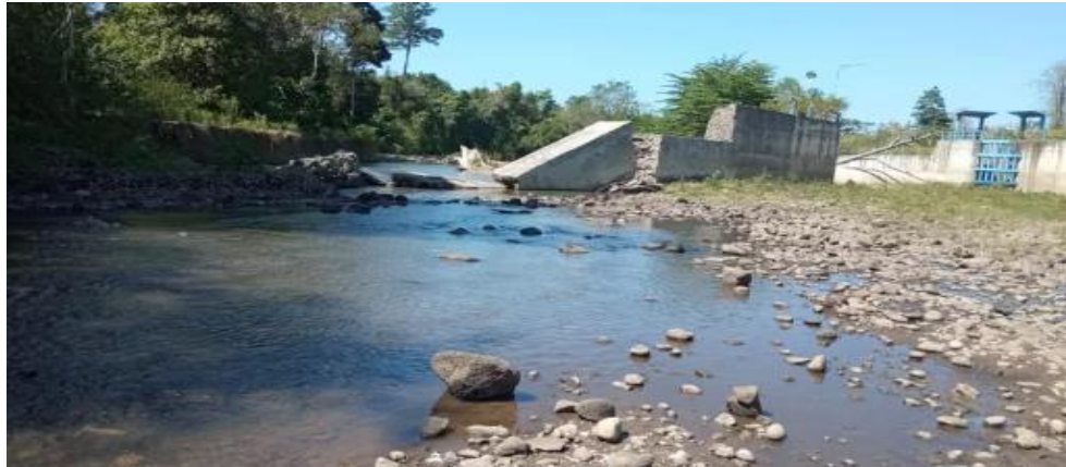
Gambar 5.3 Bendungan Wae Reca yang rusak akibat banjir
