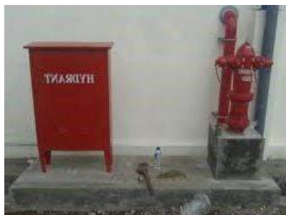
Gambar 3.38 Sistem Pemadam Kebakaran
