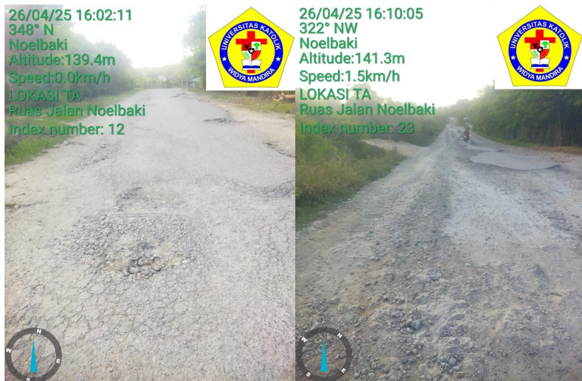
Gambar 1.2 Jalan Berlubang Dan Jalan Pengelupasan Lapis Atas
