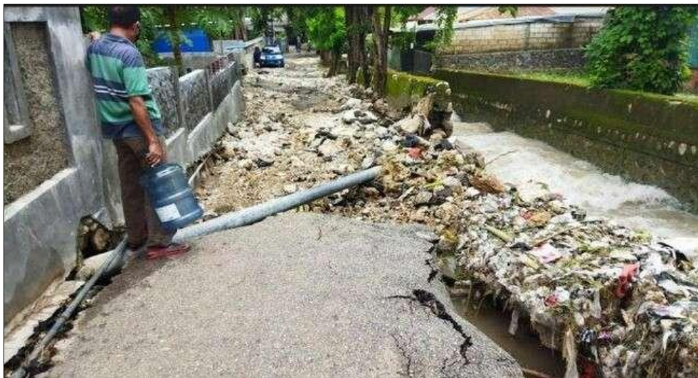
Gambar 1.1 Kondisi Jalan Gua Lordes setelah di terjang banjir
