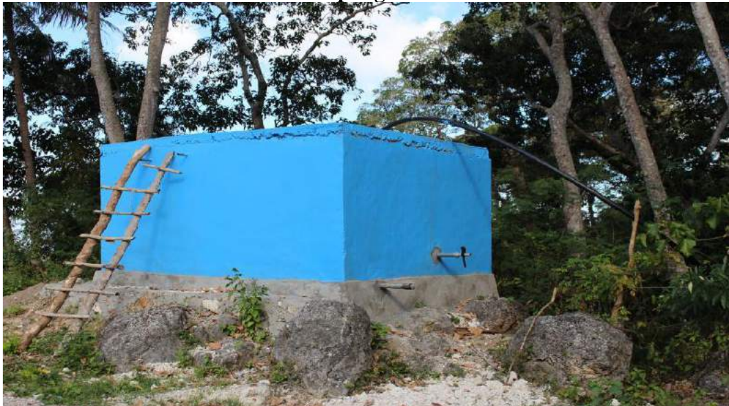
Gambar 5.4 Bak Penampungan air bersih
