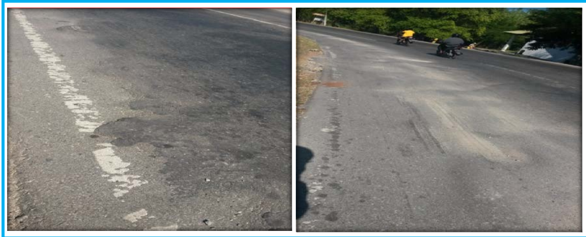
Gambar 1.2 (a) Kerusakan-kerusakan yang terjadi pada ruas Jalan Timo Raya Km.18 Noelbaki Kupang Tengah.
