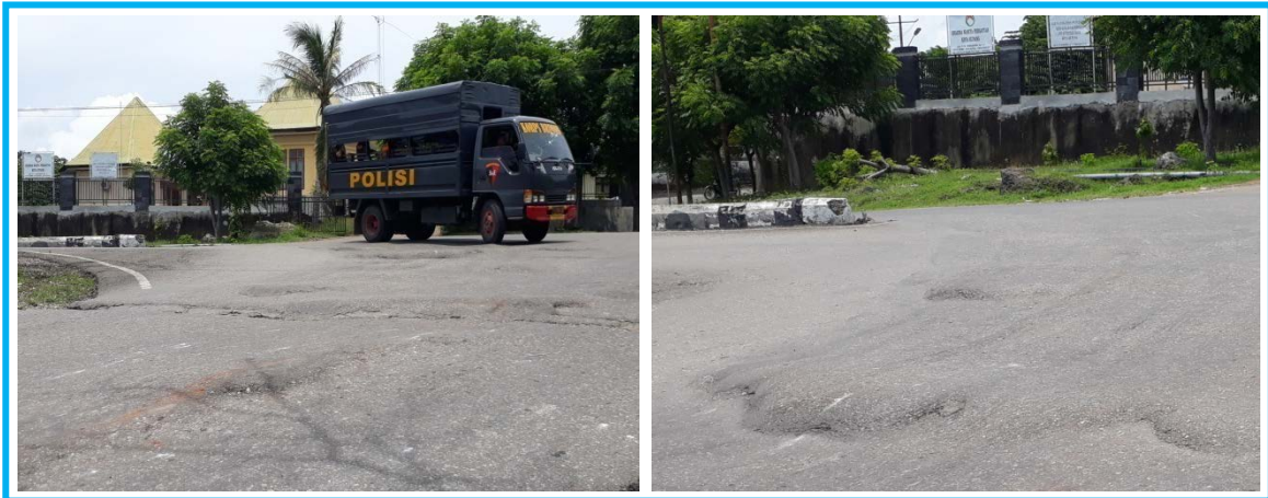
Gambar 1.2 (C) Kerusakan-Kerusakan Yang Terjadi Pada Ruas Jalan Ina Boi Kota Kupang.
