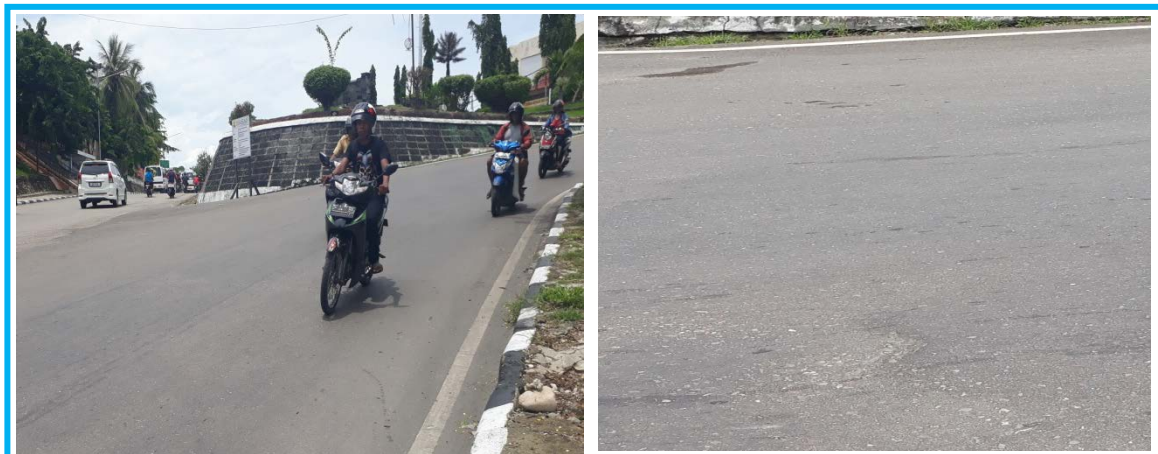
Gambar 1.2 (d) Kerusakan-Kerusakan yang terjadi Pada Ruas Jalan Soekarno Kota Kupang.
