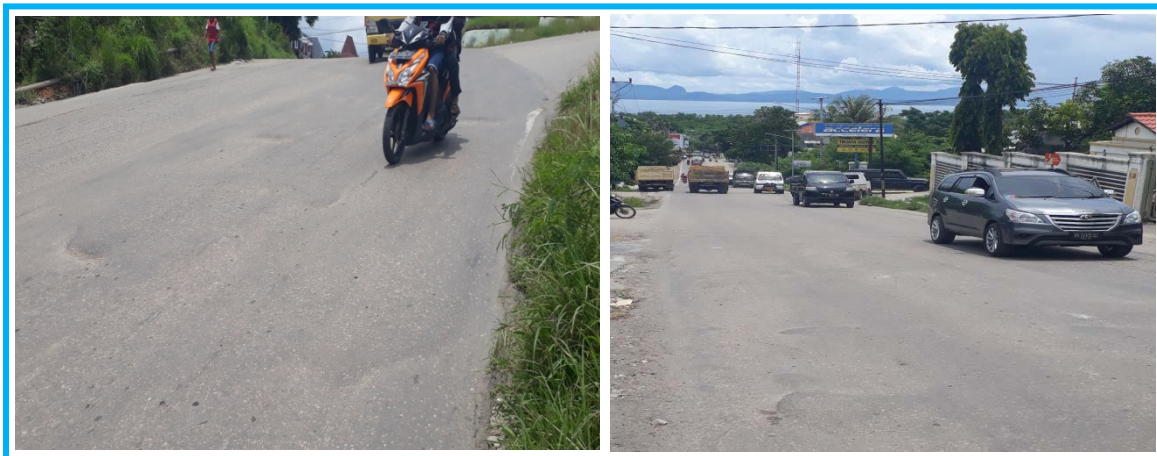
Gambar 1.2 (b) Kerusakan-kerusakan yang terjadi pada ruas Jalan Pulau Indah Kota Kupang.
