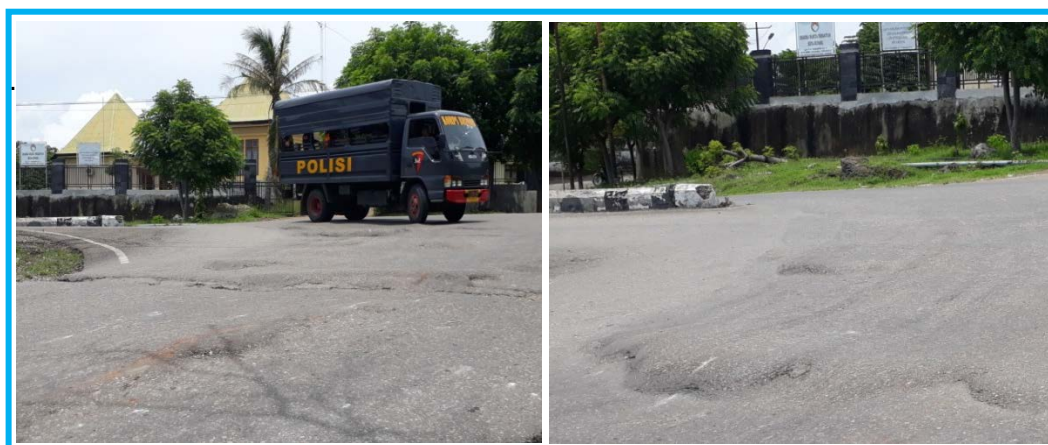
Gambar 4.3. Kerusakan-Kerusakan Yang Terjadi Pada Ruas Jalan Ina Boi Kota Kupang.
