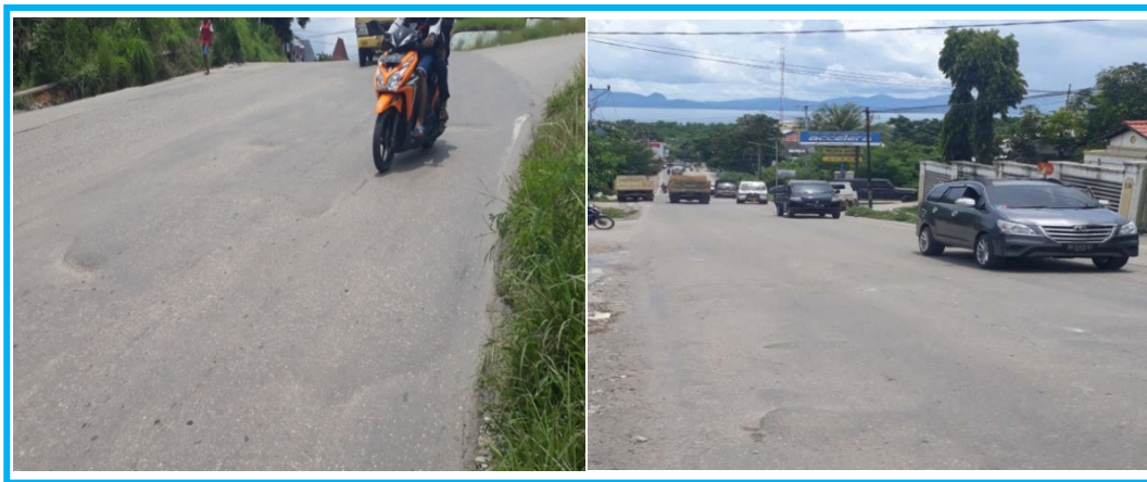
Gambar 4.2. Kerusakan-Kerusakan Yang Terjadi Pada Ruas Jalan Pulau Indah Kota Kupang.
