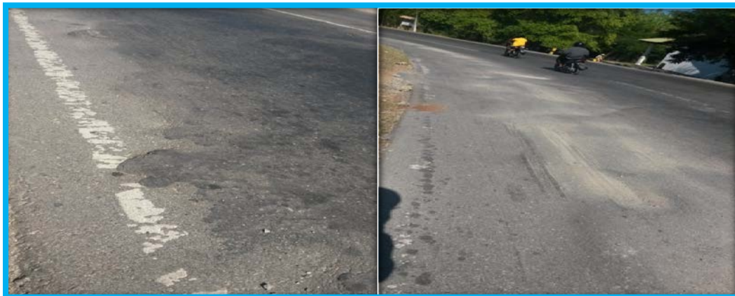
Gambar 4.1 Kerusakan-kerusakan yang terjadi pada ruas Jalan Timor Raya Km.18 Noelbaki Kupang Tengah.
