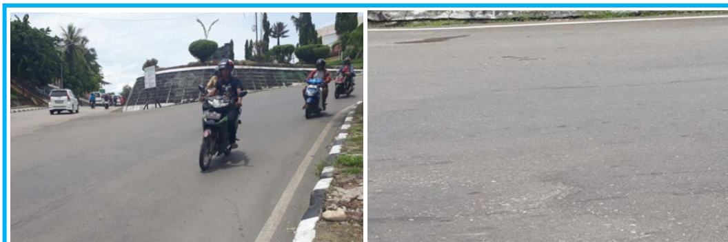
Gambar 4.4. Kerusakan-kerusakan yang terjadi pada ruas Jalan Soekarno Kota Kupang.
