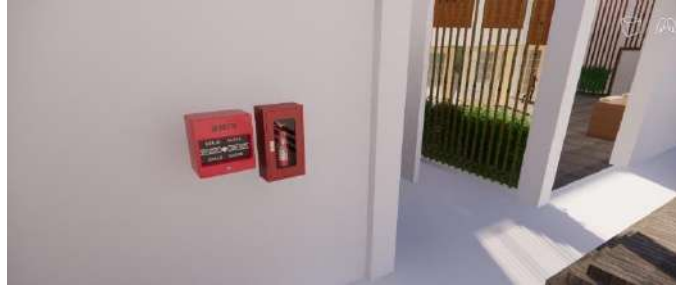
Gambar129. Sistem Pemadam Kebakaran
