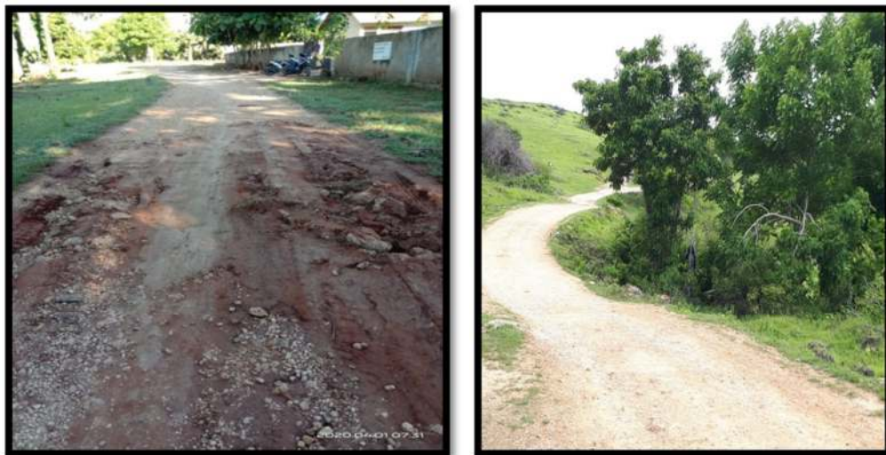
Gambar 1.1 kondisi eksisting jalan Jiwuwu-Loboadju
