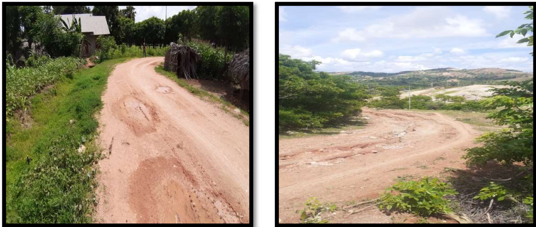
Gambar 1.1 kondisi eksisting jalan Desa Peddaro – Ramedue
