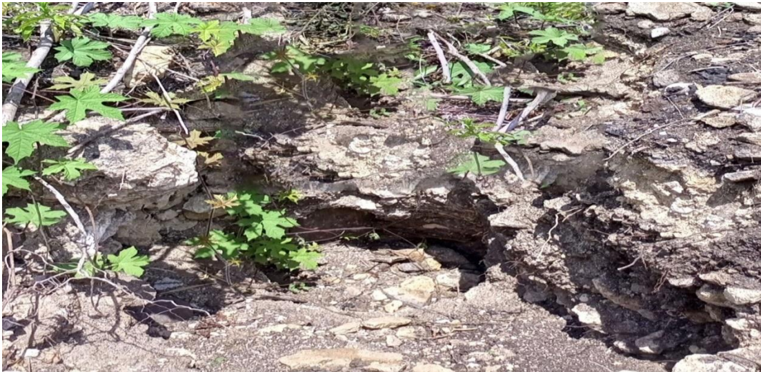
Gambar 1.3 Detail Kerusakan Tanah Pada Lokasi
