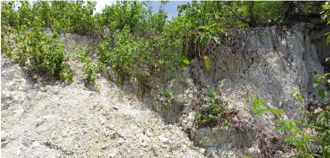
Gambar 1.2 Kerusakan Tanah Pada Lokasi
