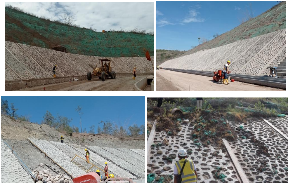
Gambar 1.1 Perkuatan Lereng Menggunakan Dinding Penahan Tanah di Lokasi Pembangunan Bendungan Manikin Kab. Kupang
