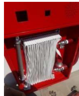
Gambar 5.36 Hydrant Gedung (Sumber : Google)
